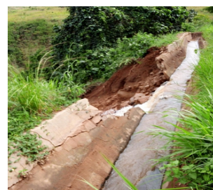
lidt af kanalvæg kolapset
