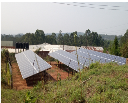
Det nuværende 25Kwp solcelleanlæg
