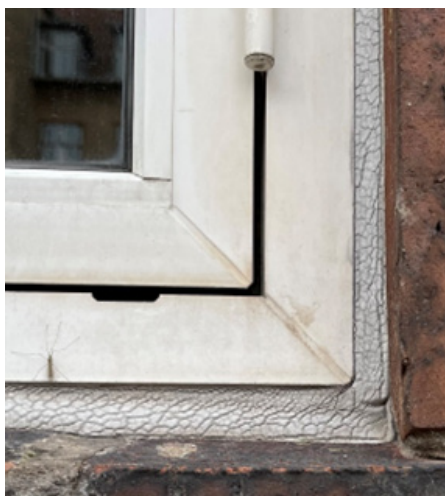
Den elastiske fuge rundt om de eksisterende plastikvinduer er udtørret, og flere steder ses fugeslip.
