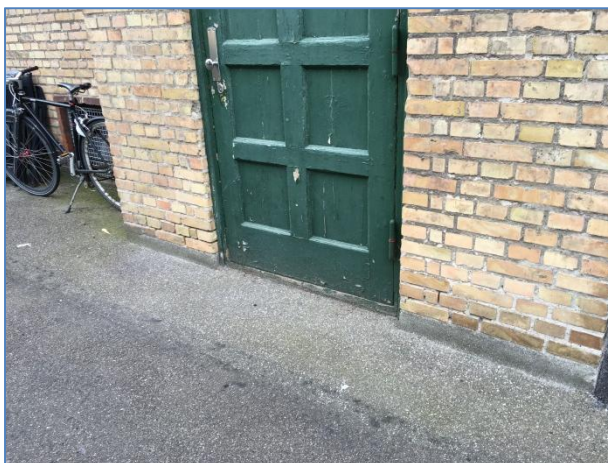
Forvitret murværk ved køkkentrappe
