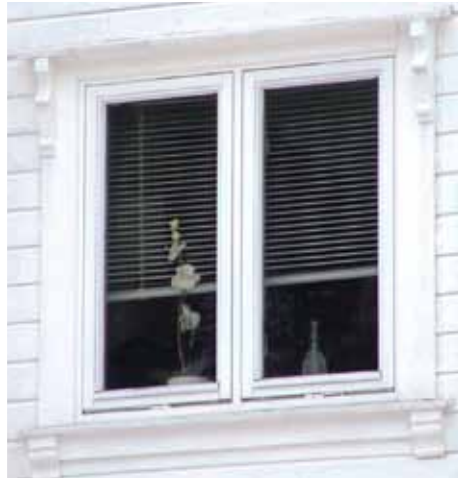
Nytt vindu – glasslist av tre m/ beslag. Feil type omramning
