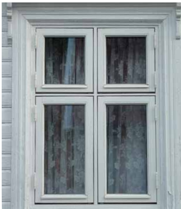
Nytt vindu. Misforhold mellom glassareal og ramme
