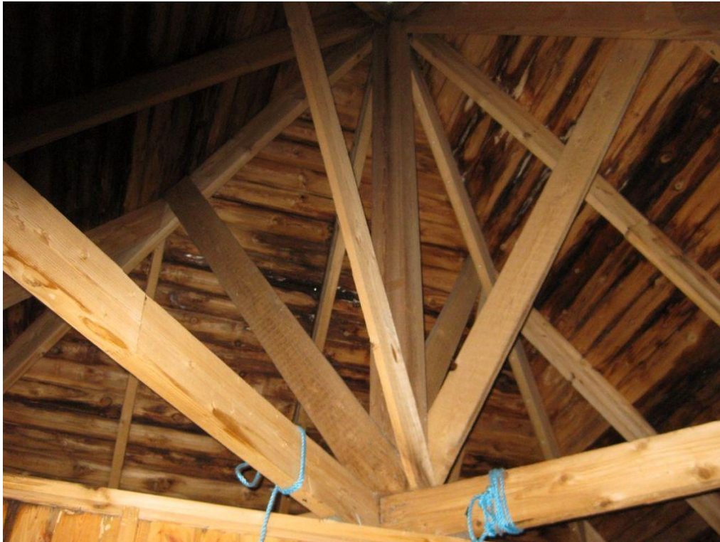
Taket på det gamle sjømerket er dårlig. Til høsten vil det legges nytt tak. FOTO: ALF ARIAN LOSHAMN
