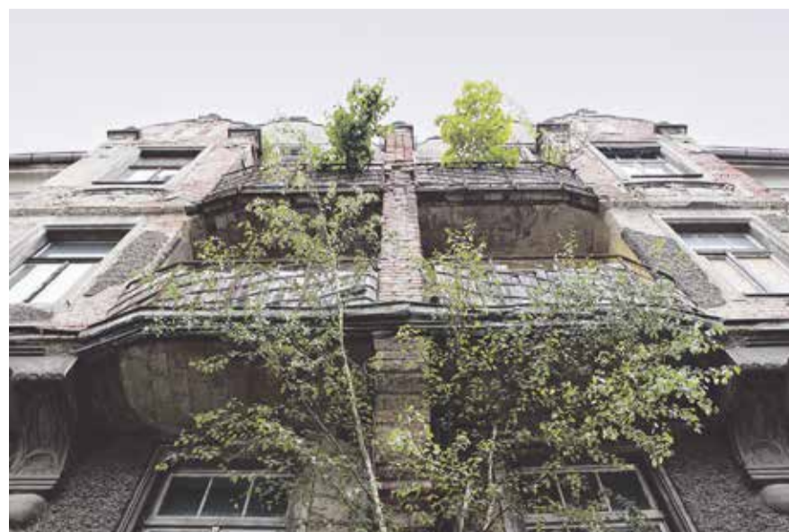
Vielen historischen Altbauten in Zittau droht der Verfall Foto: Leonie Gubela
