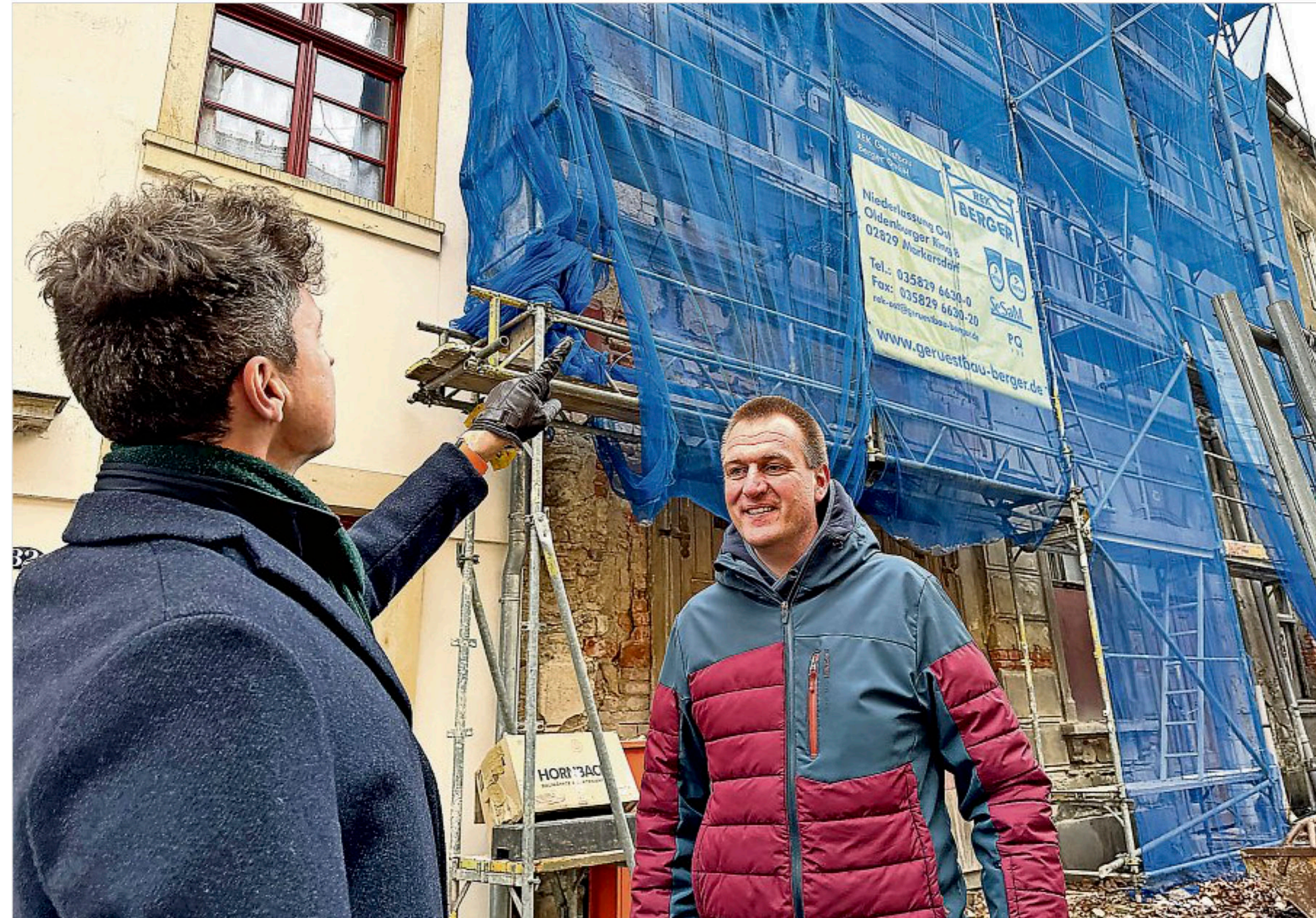
Robert Reinhold (re.) vom Referat Hochbau mit Rat- haussprecher Kai Grebasch vor dem Haus an der Böh- mischen Straße 30, das die Stadt bis Ende März not- sichern lässt.
