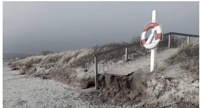
Foto: Stormflod har taget af dige og trappeanlæg syd for Aarhus. December 2023.
