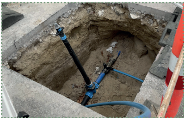
Tilsyn, opmærksom på undermineret vej.
