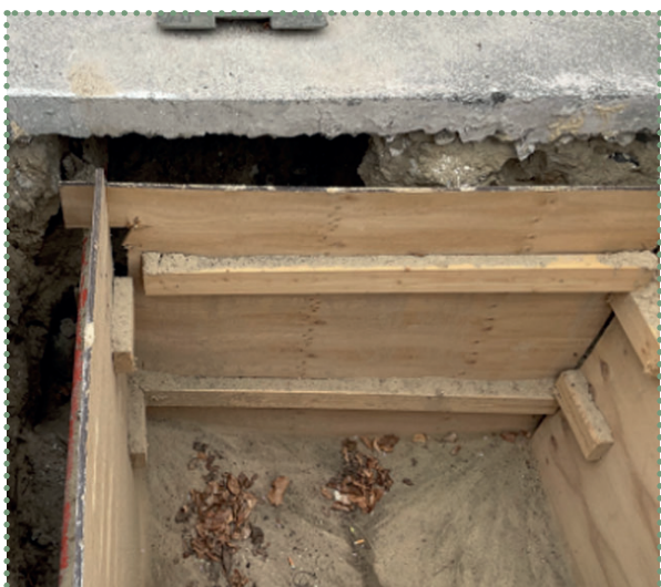
Tilsyn, opmærksom på manglende bagfyldning af afstivning.
