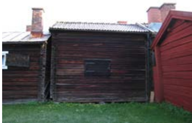
Kammare 127, södra fasaden före åtgärd.
