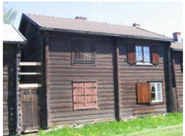
Kammare 257-260, södra fasaden före åtgärd.
