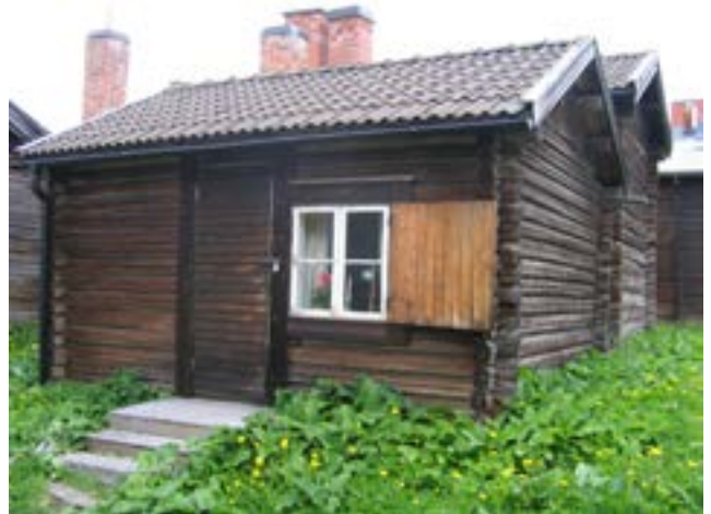
Kammare 437, södra fasaden före åtgärd.
