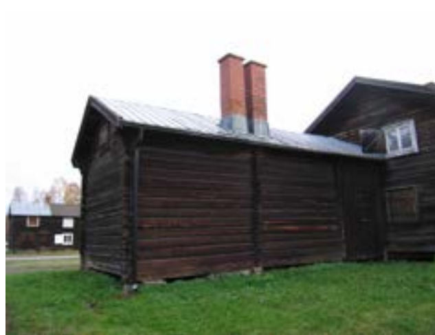
Kammare 147-148, södra fasaden före åtgärd.
