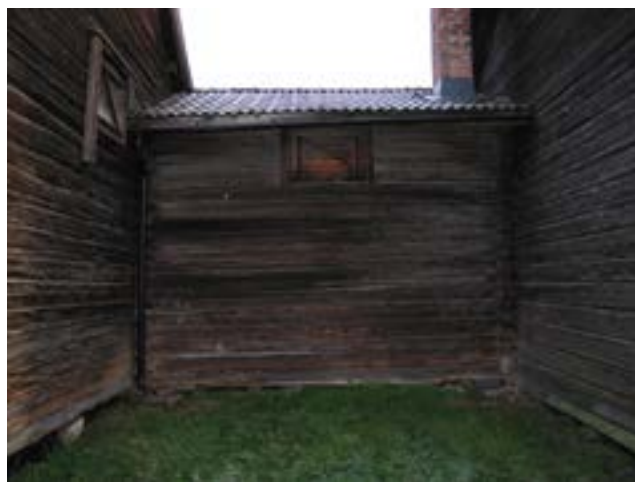
Kammare 439, södra fasaden före åtgärd.
