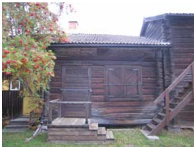
Kammare 431-432, södra fasaden före åtgärd.
