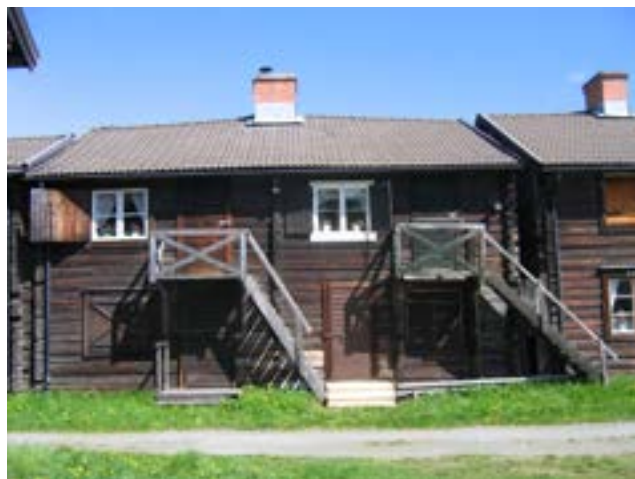
Kammare 409-416, södra fasaden före åtgärd.
