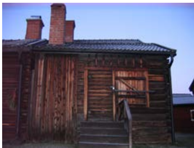
Kammare 200, södra fasaden före åtgärd.
