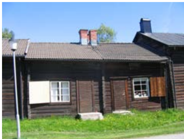
Kammare 286-289, södra fasaden före åtgärd.
