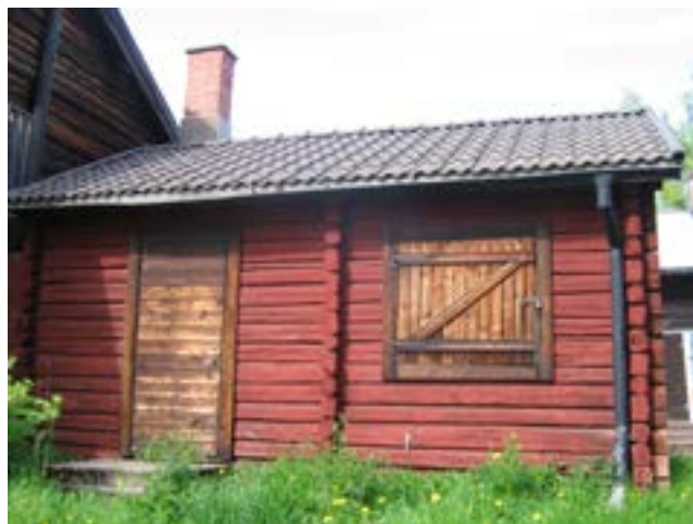
Kammare 440, södra fasaden före åtgärd.
