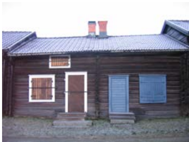
Kammare 82-85, fasad mot söder före åtgärd.
