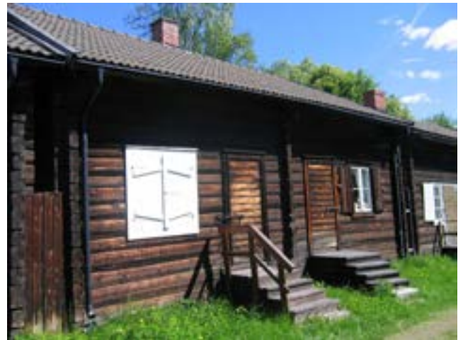
Kammare 304-307, södra fasaden före åtgärd.
