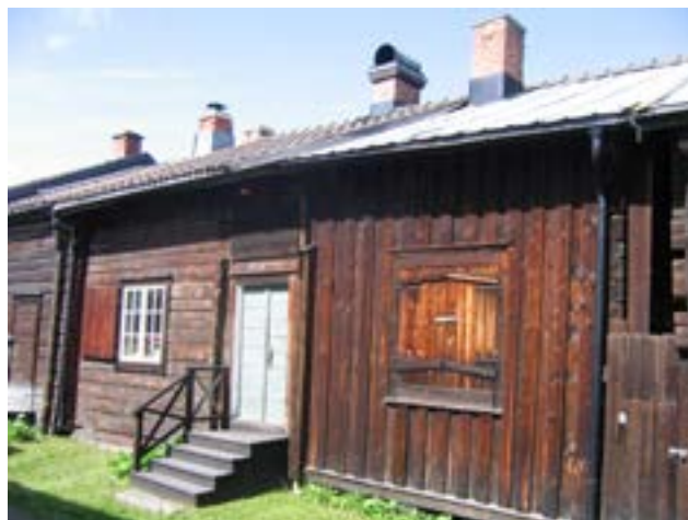
Kammare 93-96, södra fasaden före åtgärd.
