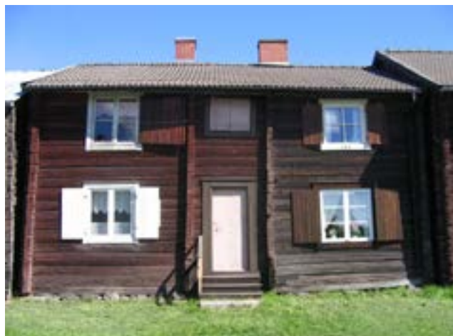
Kammare 237-244, södra fasaden före åtgärd.
