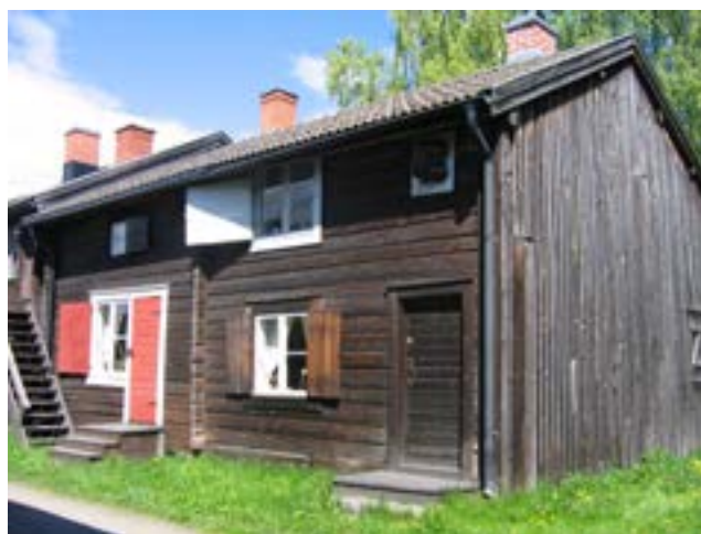
Kammare 319-320, södra fasaden före åtgärd.
