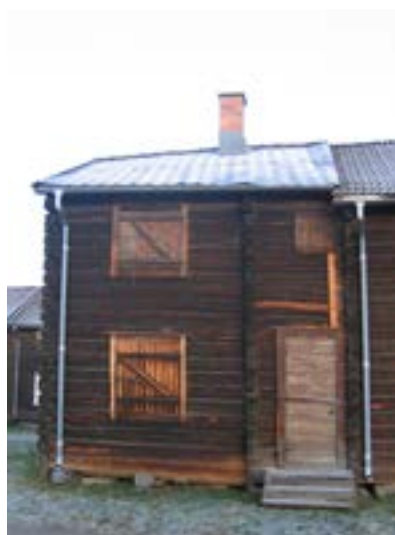
Kammare 17-20, fasad mot söder före åtgärd.
