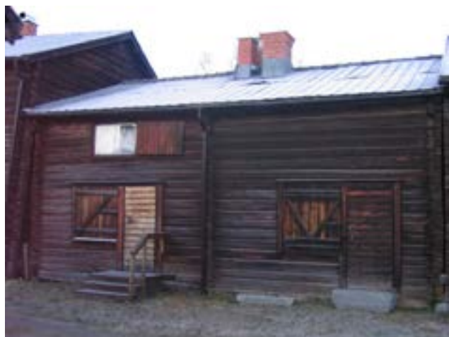
Kammare 62-65, fasad mot söder före åtgärd.
