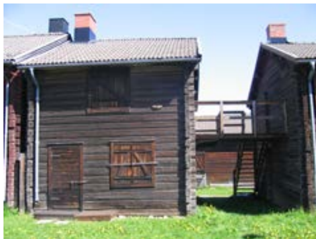
Kammare 375-378, södra fasaden före åtgärd.
