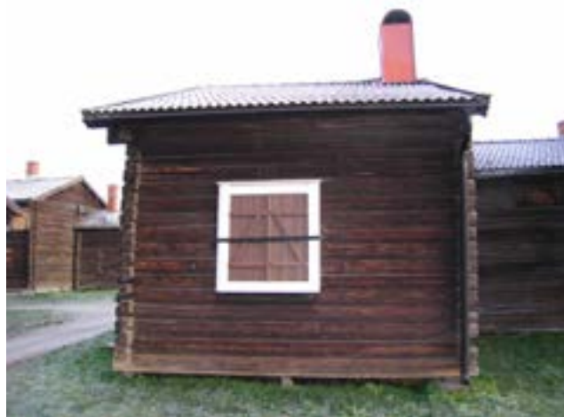
Kammare 174-175, södra fasaden före åtgärd.
