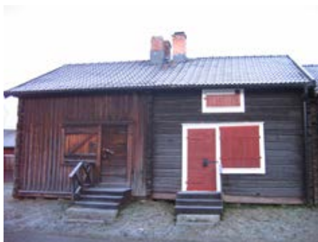
Kammare 78-81, fasad mot söder före åtgärd.
