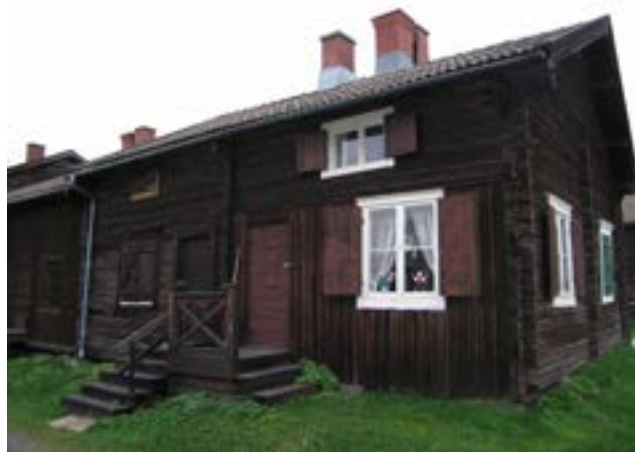
Kammare 43-46, fasad mot söder före åtgärd.
