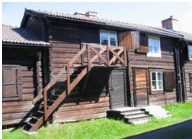
Kammare 425-428, södra fasaden före åtgärd.
