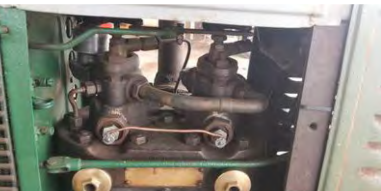
Här syns insprutningssystemet på Hugos BM-10.
