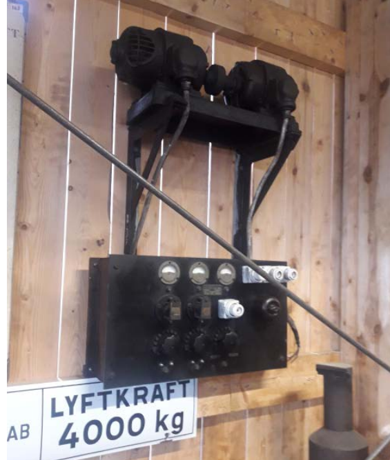
En gammal batteriladdare. Elmotorn driver en generator som laddar batteriet.
