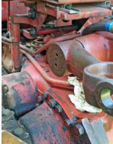
Nu är lyftlänk, de 2 skruvarna med låsbricka och den stora brickan borta.
