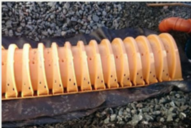
▲ Připojování vsakovacího tunelu k regulační šachtě. Tkanou geotextilií se brání průniku sedimentu do prostoru podzemní rýhy.
