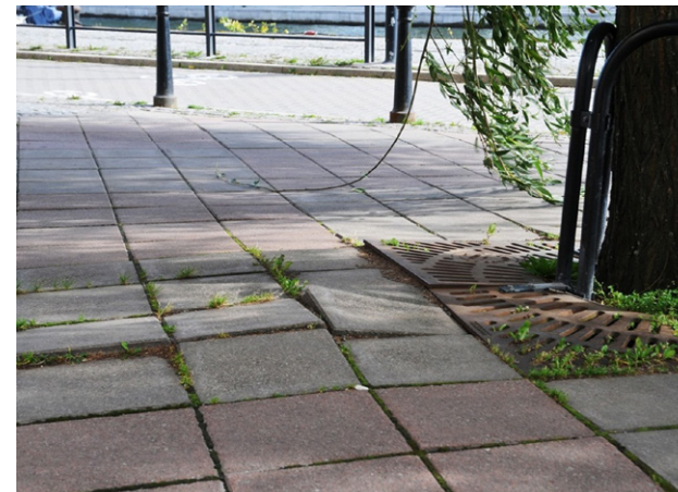
▲ Poškození dlažby způsobené kořeny v důsledku nedostatečného prokořenitelného prostoru a výměny plynů.
