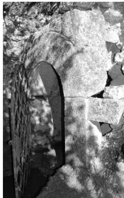
Fig. 16. Sortie du collecteur principal hors des murs de la ville.
