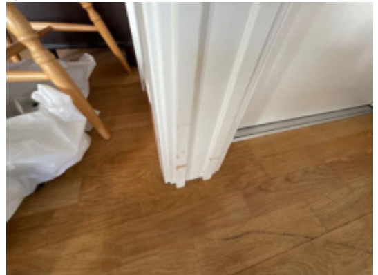
Er noe bruksmerker på karmen/kamrlister
