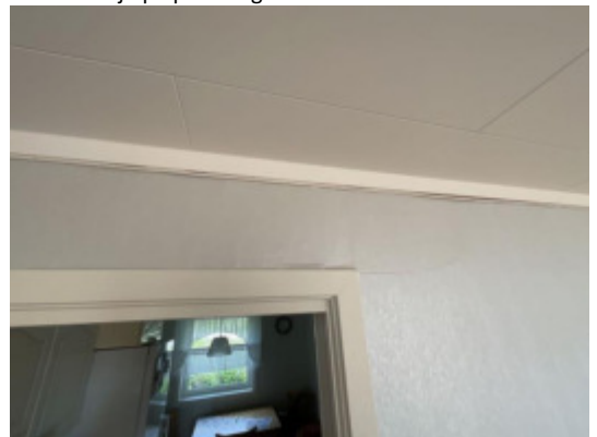
Tapet har noe sprekkdannelse samt stedvis noe løsnet fra underlaget.
