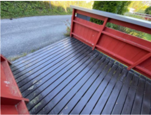
Terrasebord og rekkverk har behov for ny overflatebehandling.
