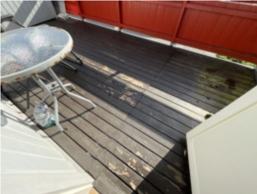
Terrasebord og rekkverk har behov for ny overflatebehandling.
