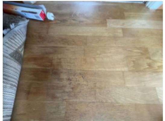
Større bruksslitasje på parkett gulv.
