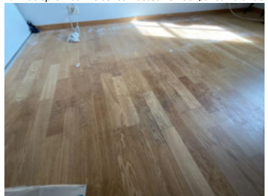
Større bruksslitasje på parkett gulv.
