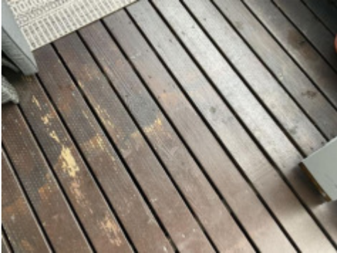
Terrassebord har behov overflatebehandling.
