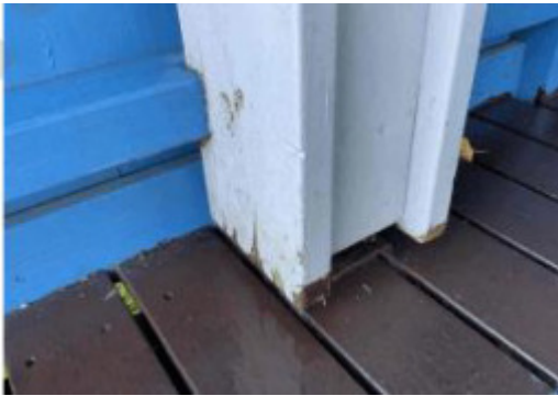
Fuktopptrekk i bærestolpe
