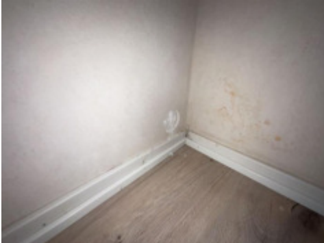
Skjolder på overflate på soverom.
