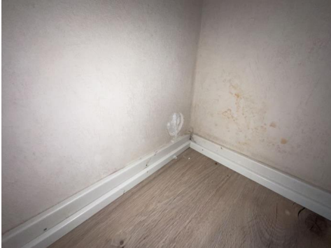
Skjolder på overflate på soverom.
