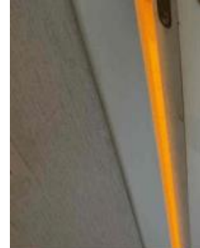
Noe svelling på baderomsdør
