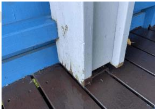
Fuktopptrekk i bærestolpe
