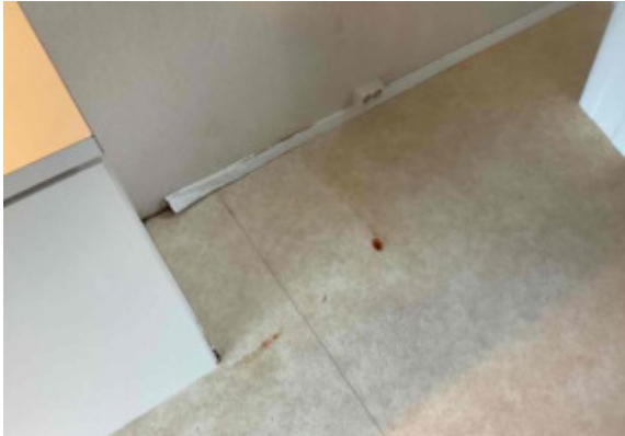
Rustmerker på gulv etter kjøleskap samt fuktskadet listverk.
