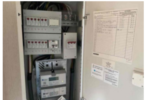
Sikringsskap er plassert i gang med eldre automatsikringer.
