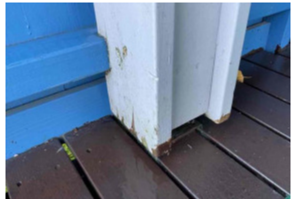
Fuktopptrekk i bærestolpe.
