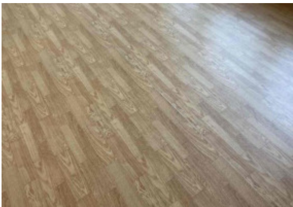
Gulvbelegg løsner i skjøter.
