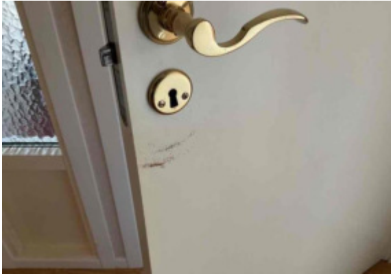
Bruksslitasje på dører.
