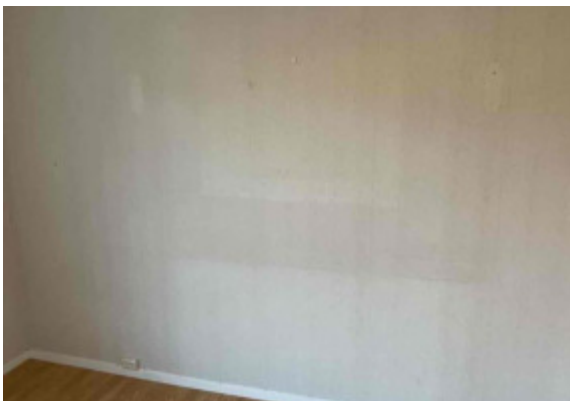
Eldre overflater på vegg. Løse tapetskjøter og sprekker i hjørner.
