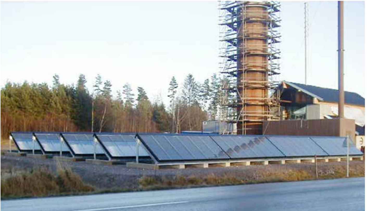
I Vagnhärad installerades 20 st Aquasol Big 13 med ca 250 m 2 aktiv solfångaryta.
