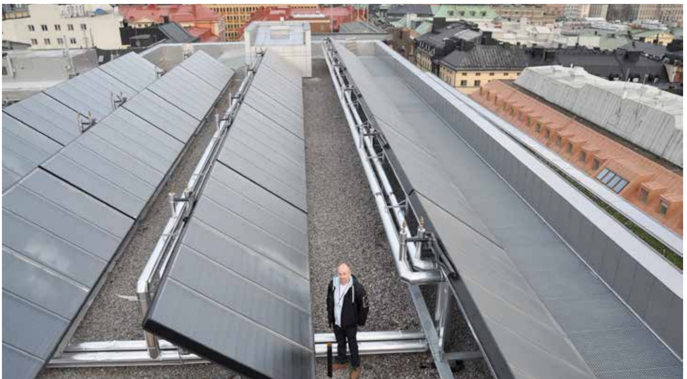
Montage av solfångaranläggning kvarteret Loen, Stockholm, har utförts av Aquasols återförsäljare Heat-On.
