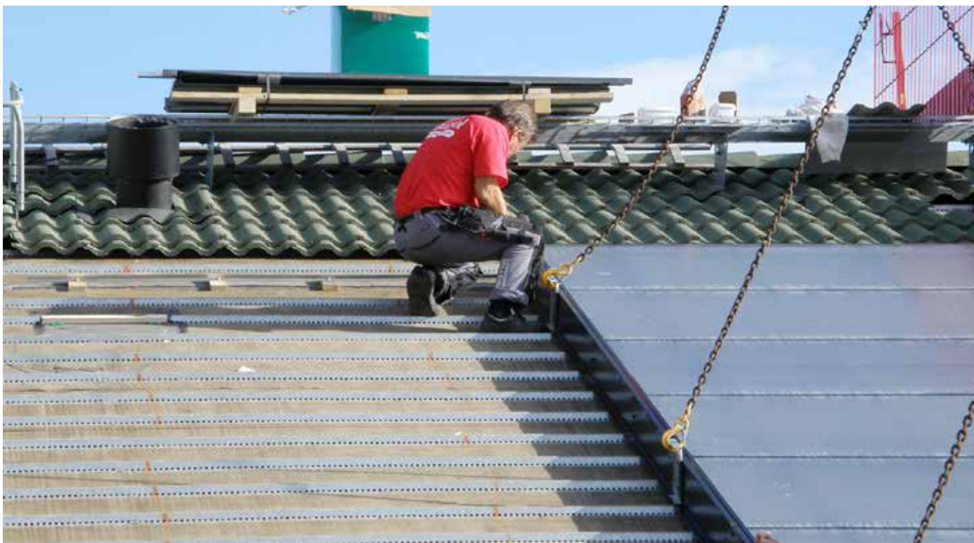
Solfångare fästs med montageskruv i den monteringsfals som finns runt om på solfångaren.
