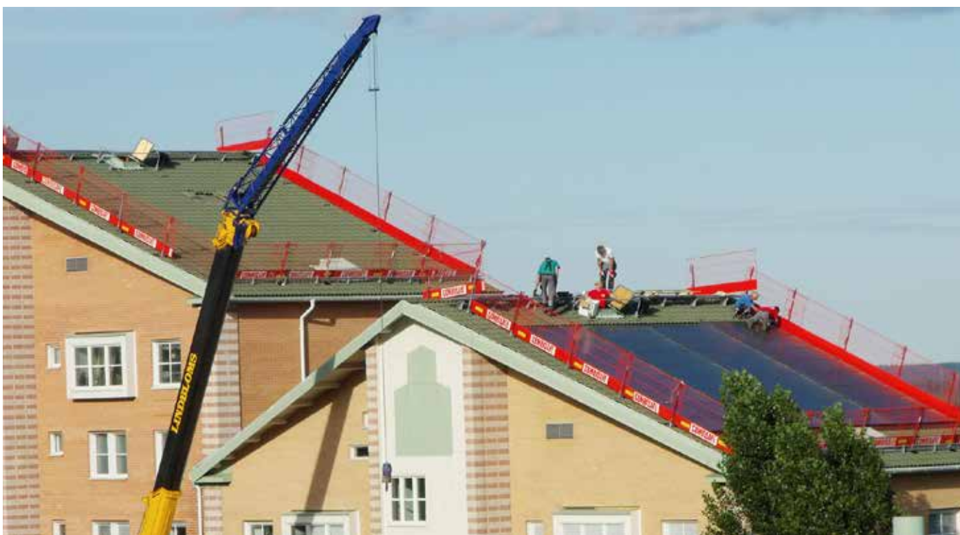
Solfångarna, i detta fall 4 st BIG 17 AR, bildar efter färdigt montage och inplåtning en heltäckande yta.
