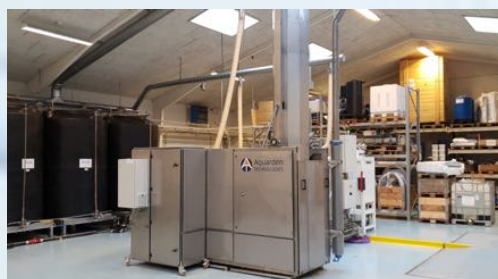
Aquardens SCWO-anlegg som benyttes for destruering av PFAS.
