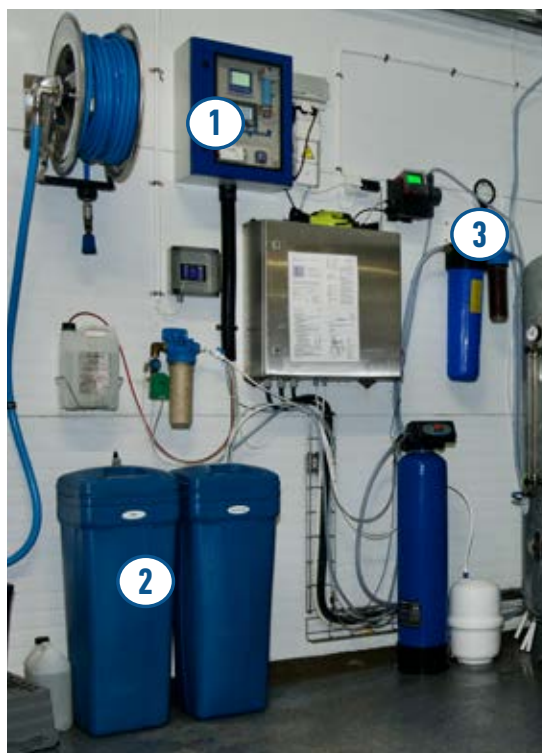
Anolytechs system som producerar AnoDes på plats består av en styrenhet monterad på väggen (1), behållare med salt (2) och en blandningsmodul (3). Bilden visar en standardinstallation.
