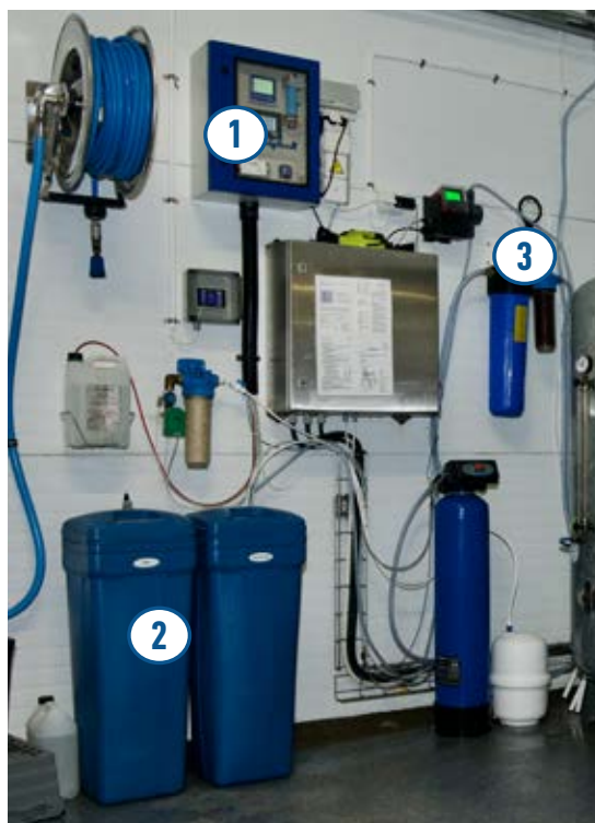
Anolytechs system som producerar AnoDes på plats består av en styrenhet monterad på väggen (1), behållare med salt (2) och en blandningsmodul (3). Bilden visar en standardinstallation.
