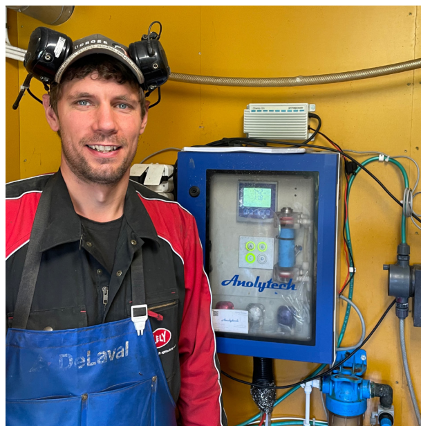
Kenneth Gunnarsson framför Anolytech-installationen.
