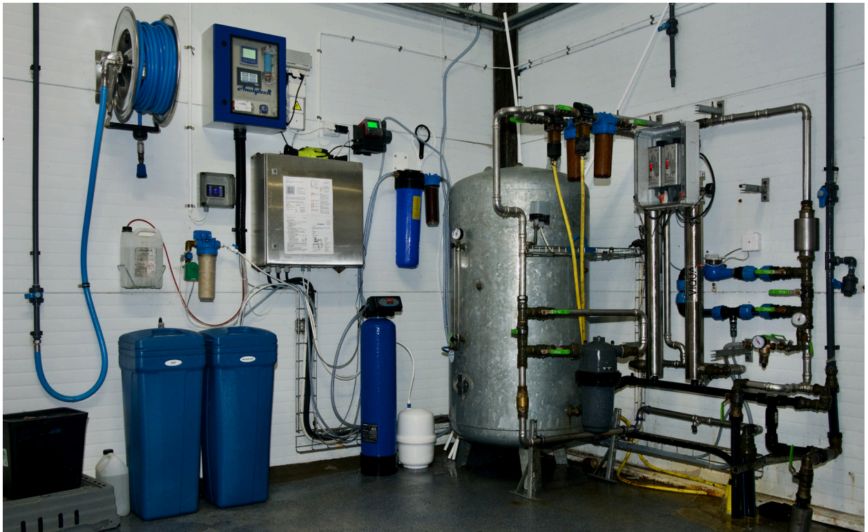
Anolytechs system som produceras AnoDes på plats består av en styrenhet monterad på väggen (1), behållare med salt (2) och en blandningsmodul (3).
