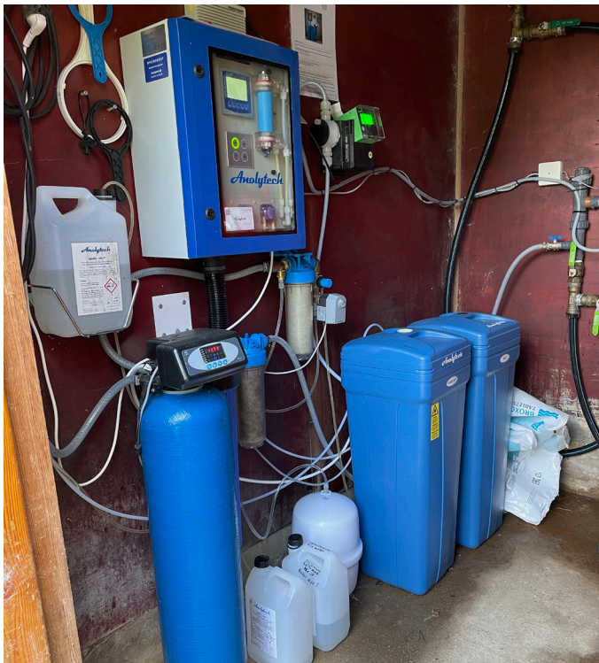
Efter goda erfarenheter av det första systemet från Anolytech har Gallus installerat ytterligare två i olika hus och kopplade till olika vattenkällor.
