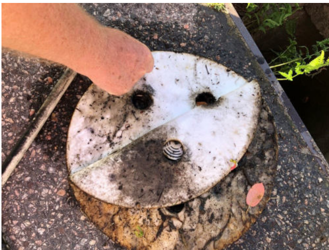
Ett av de filter som byttes
