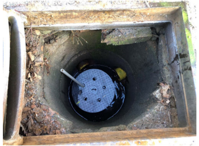
Filter i dagvattenbrunn (gallerbrunn).
