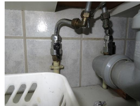
Vandinstallation i badeværelse
