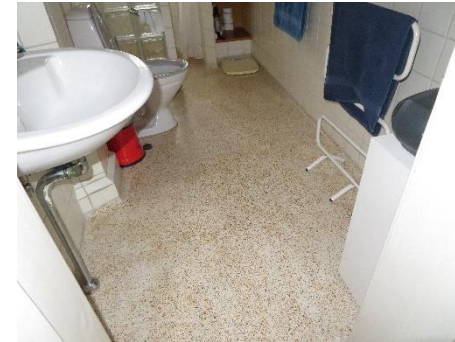
Gulvvarme i badeværelse
