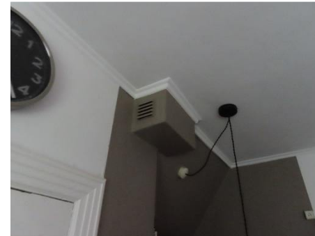
Rist på ventilationskanal i køkken
