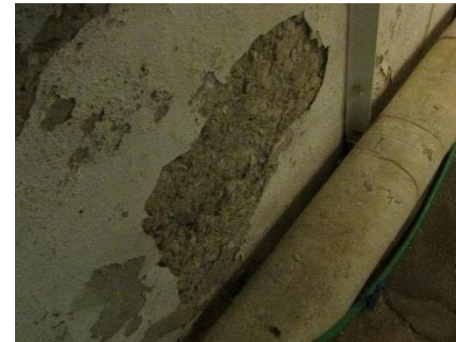
Kælderydervæg med afskallende puds
