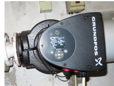
Nyere energieffektiv cirkulationspumpe
