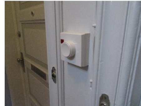
Lysinstallation i opgang
