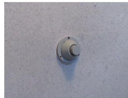
Lysinstallation i opgang
