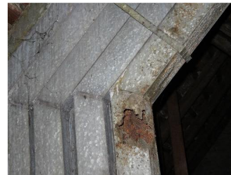
Rustskade på ventilationskanal på loftet
