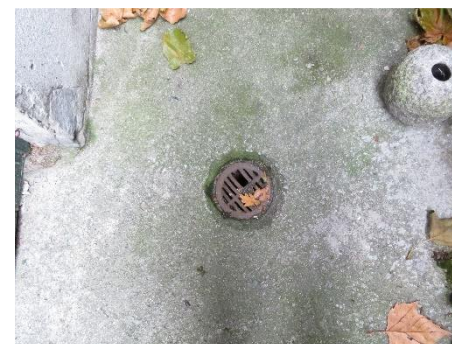
Gulvafløb i kælder
