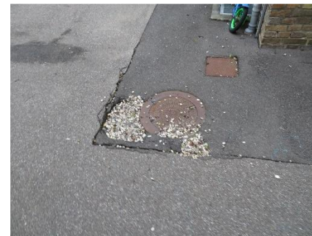
Kloakbrønd i gård med tegn på skade
