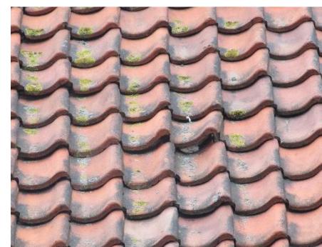
Understrygning skubber tegl op
