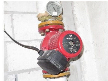
Ældre cirkulationspumpe til varmt brugsvand
