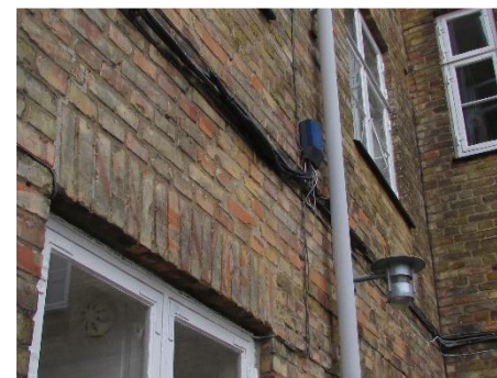
Kabler på facaden
