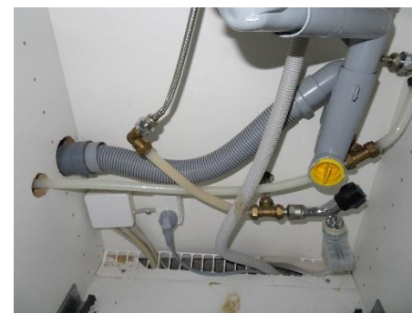
Vandinstallation i køkken
