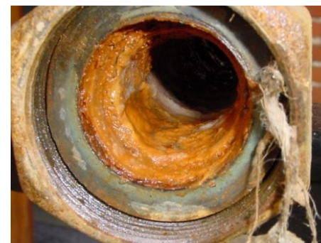
Eksempel på biofilm med slimdannelse i vandrør
