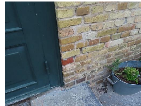
Udvaskede fuger ved køkentrappedør
