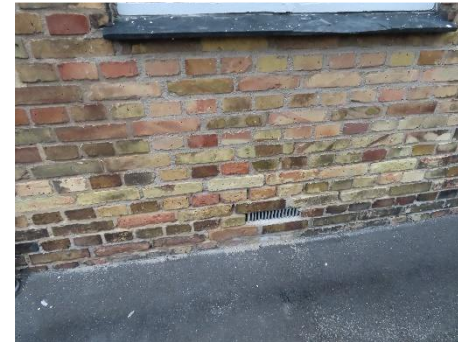
Udvaskede fuger i murværk
