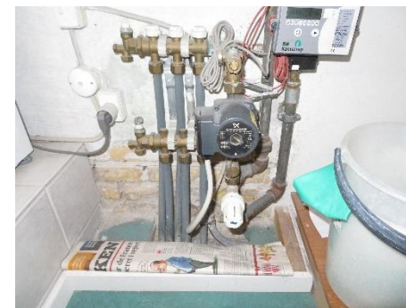
Gulvvarme i kælder
