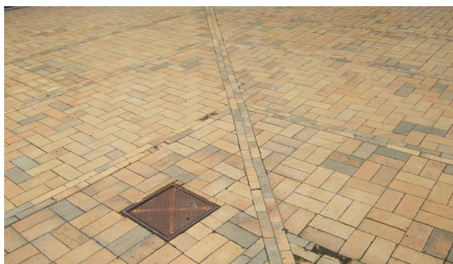
Sammenskæring og vandrende i teglbelægninger.
