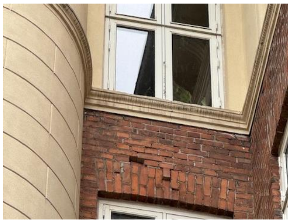
Eksempel på dårligt murværk, hvor fuger er væk, mursten skubbes ud og der ses en revne i gesimsbåndet.
