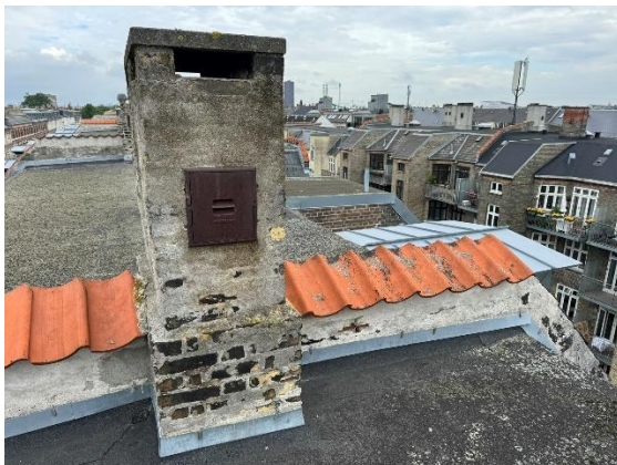
Eksempel på skorsten og brandkan med defekte fuger.
