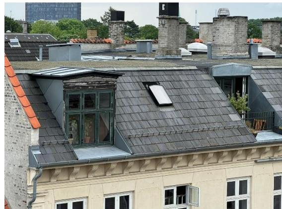
Foto viser eksempel på kvist, som skal renoveres, tagvindue i bolig, som skal udskiftes samt inddækning mellem skråt og fladt tag, som skal renoveres.
