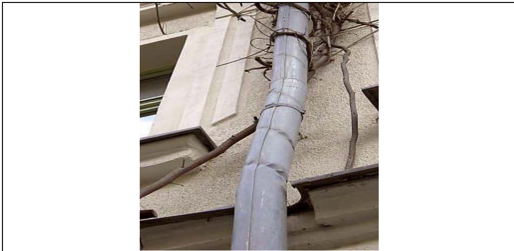
Figur 2.2 Nedløbsrør deformeret af blåregn ( Wisteria )
